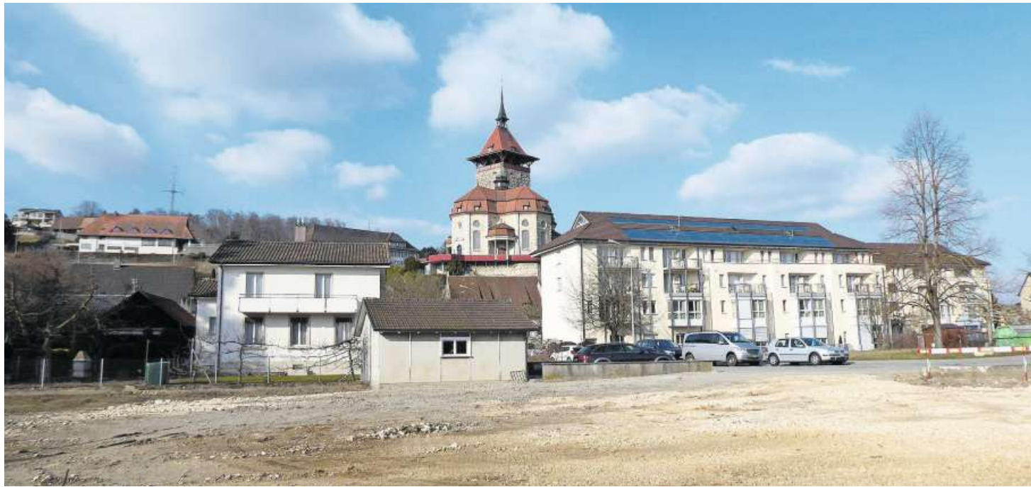
Der vorgesehene Bauplatz ist planiert, das Garagenhäuschen wird abgerissen. Schräg dahinter das bestehende Heimgebäude. Bild: zvg
